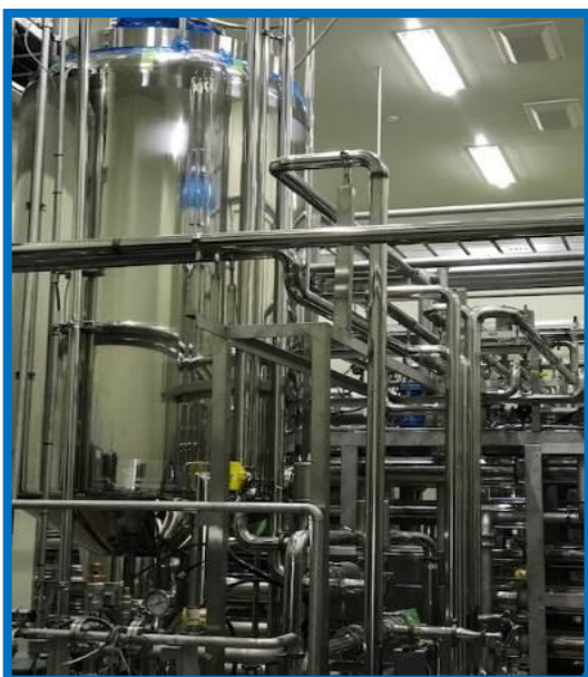
薬液供給ライン
