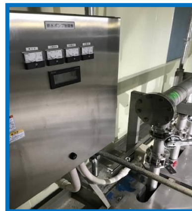
排水ポンプ運転盤
