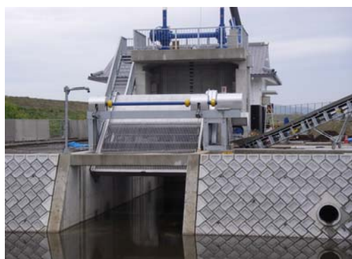
高島排水機場
